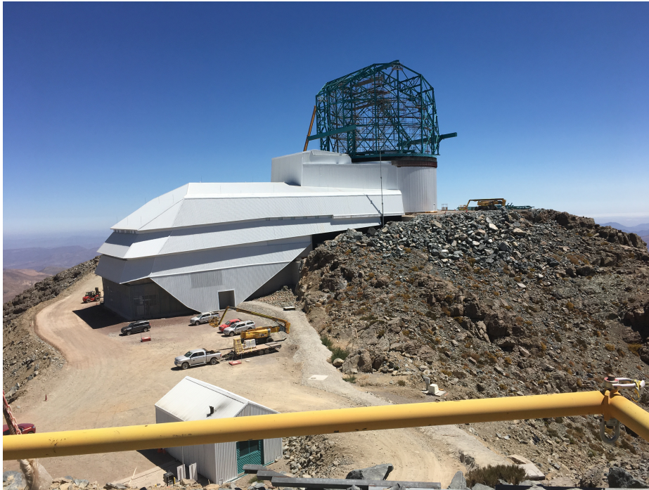
Figure 4.1 – Photographie du bâtiment abritant LSST datant de mars 2019. Le dôme en lui-même abritant le télescope et en construction.
